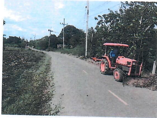
วันที่ ๑๓ สิงหาคม ๒๕๖๘ ดำเนินการปรับปรุงภูมิทัศน์ ตัดหญ้าริมถนนสาธารณะ ซอยบุญโถมถ และซอยช่างจรัล
